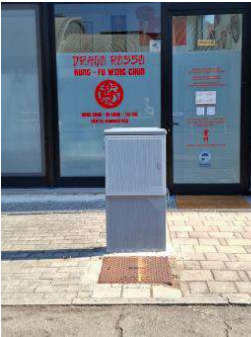
Quadro posizionato sul marciapiede di Via Nabucco al quale è previsto di allacciarsi
