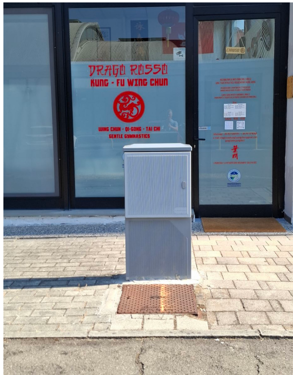
Quadro posizionato sul marciapiede di Via Nabucco al quale è previsto di allacciarsi
