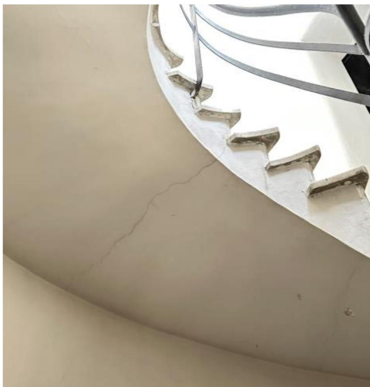
Lesioni ripetute in corrispondenza dei vani scala originari
