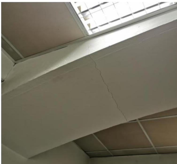
Lesione localizzata in corrispondenza delle reni di un arco al piano seminterrato
