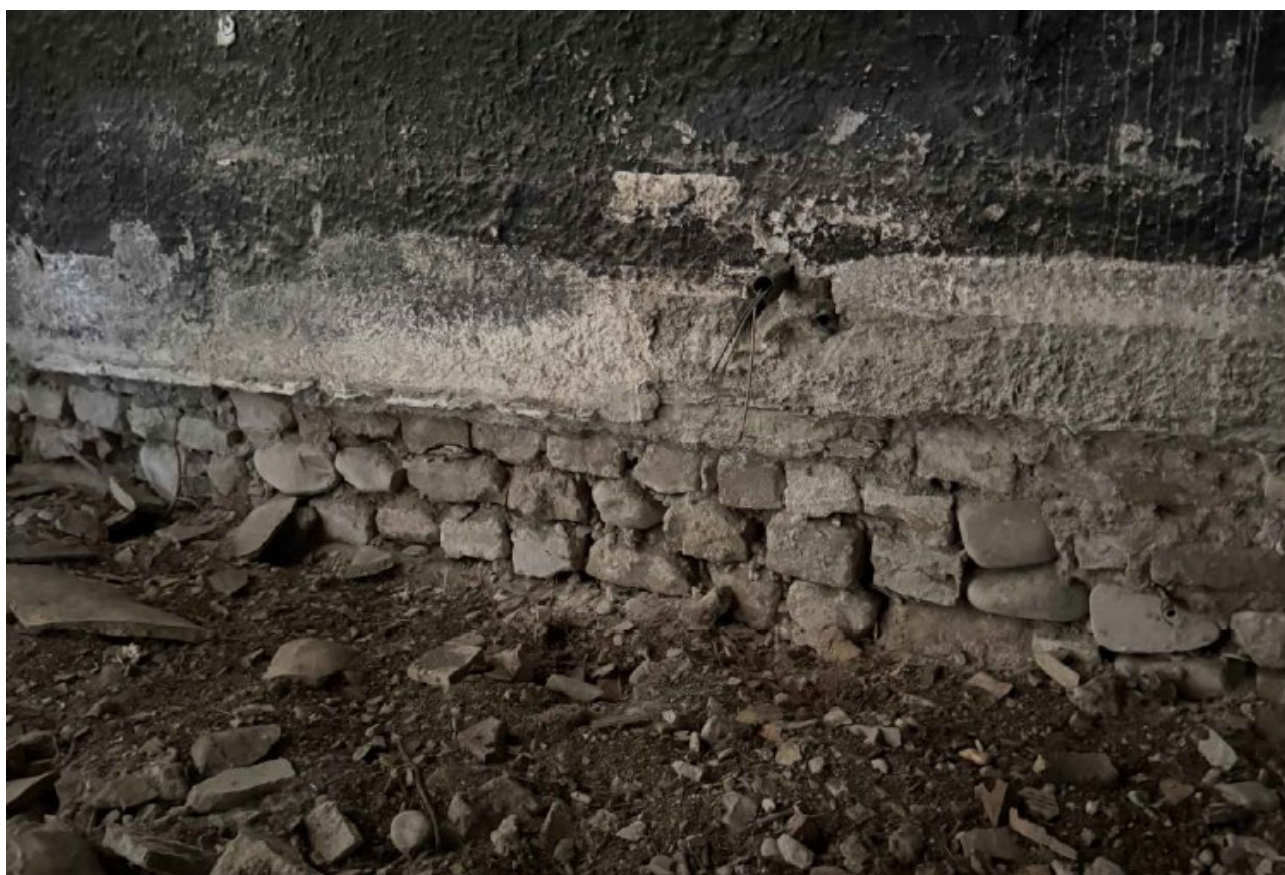
Teatro del Vicolo – dettaglio dei muri interni, in alcune aree il pavimento non è presente
