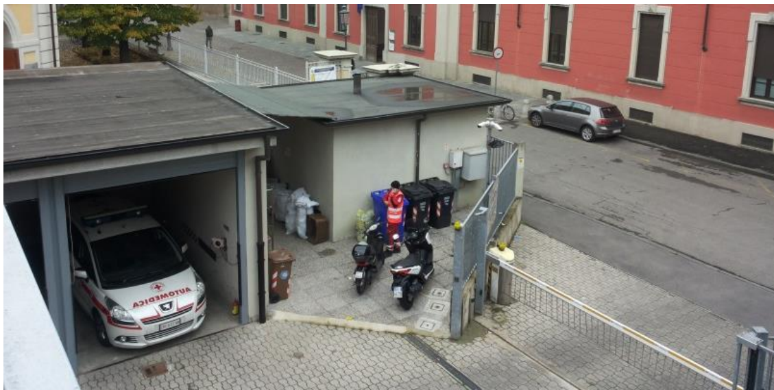
Fig. 4.13 – Cabina elettrica a fianco del deposito mezzi della Croce Rossa Italiana – Comitato di Parma.
