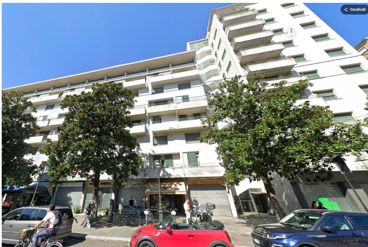
Figura 5 Edificio in Strada Garibaldi - facciata est. Alcuni balconi presentano evidenti segni di degrado. L'edificio è più alto di 24 m.
