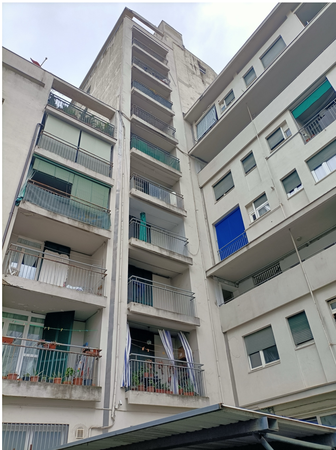
Figura 6 Edificio in Strada Garibaldi - facciate sud ed ovest. Alcuni balconi presentano evidenti segni di degrado. L'edificio è più alto di 24 m.
