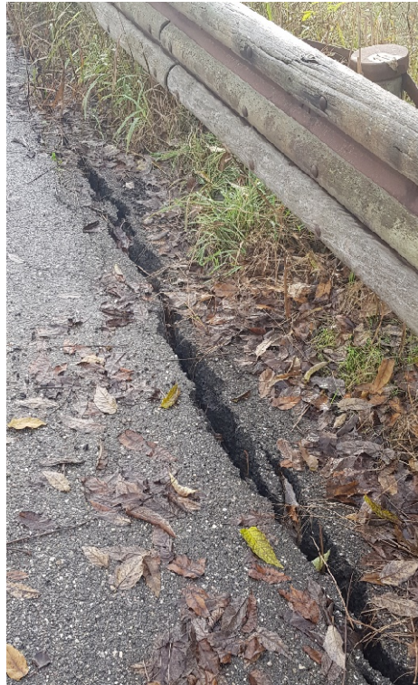
Figura 15: Fessurazione nei pressi della barriera di sicurezza
