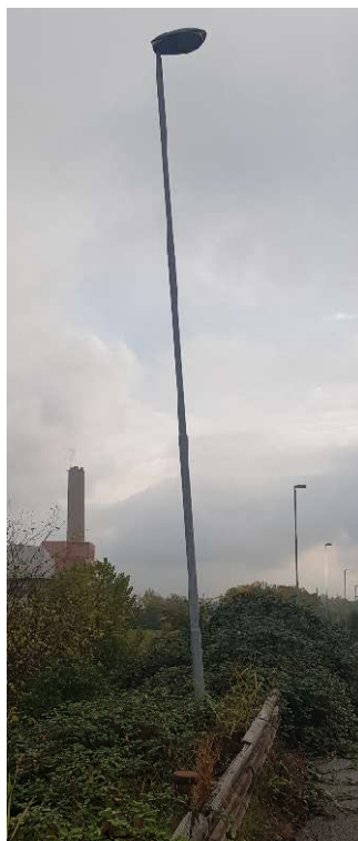
Figura 5: Palo di illuminazione con perdita di verticalità
