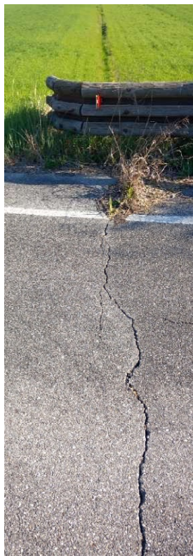
Figura 12: Fessurazione per h rilevato circa 2m
