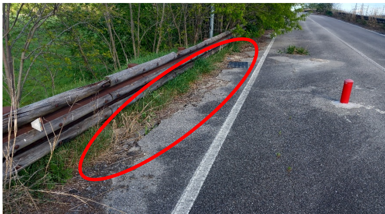
Figura 14: Fessurazione nei pressi della barriera di sicurezza nei pressi del piezometro rilevato ovest
