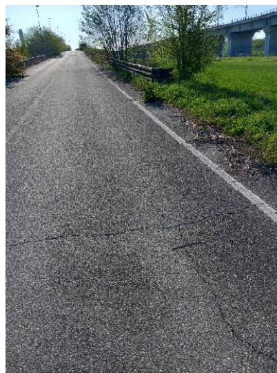
Figura 13: Fessurazione per h rilevato < 2m
