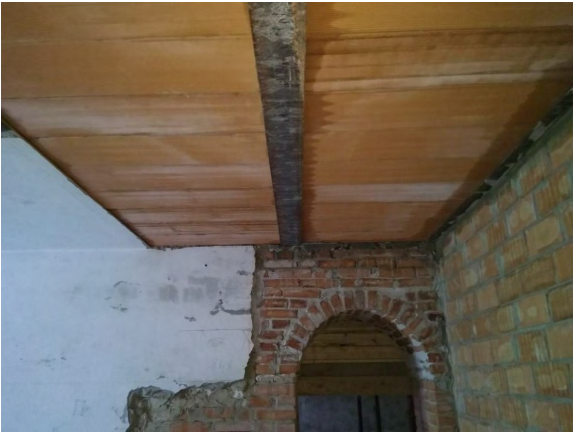
3 – vista interna del locale tecnico all'ammezzato
