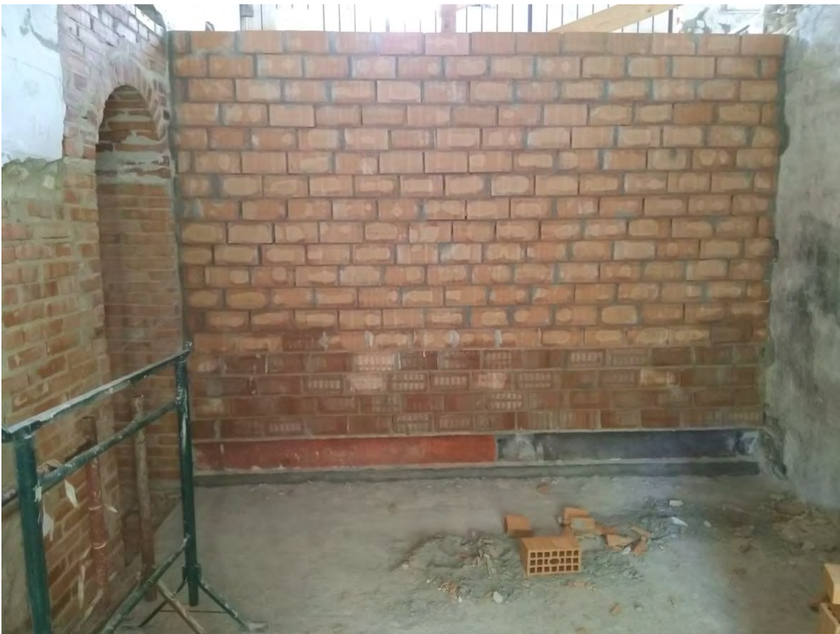
4 – vista interna del locale tecnico all'ammezzato
