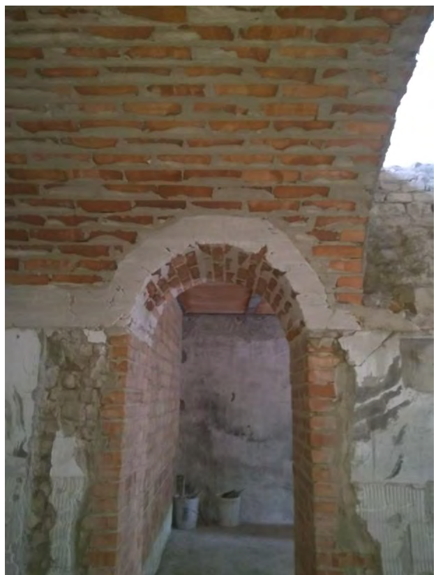
2 – Ingresso Locale tecnico all'ammezzato
