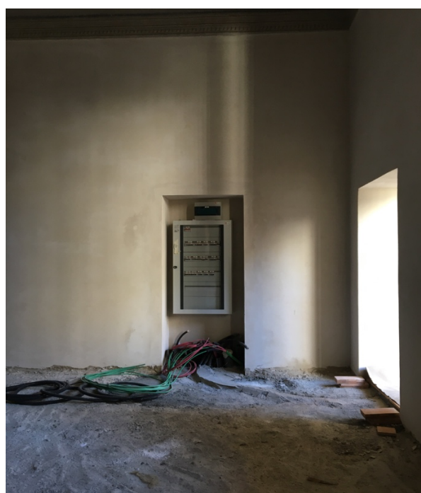
5 – Armadio dei quadri elettrici
