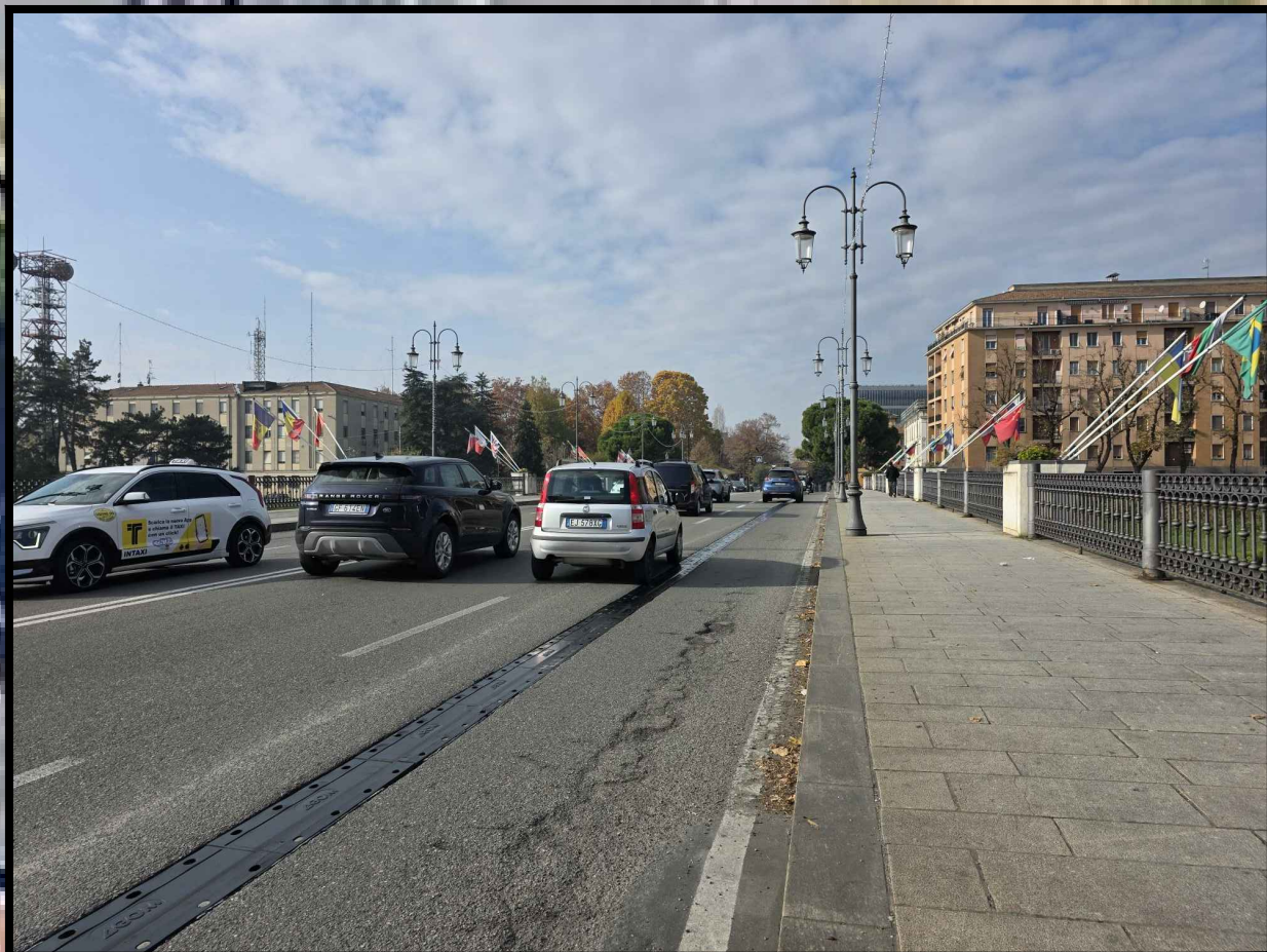
Superficie bituminosa da fresare e ripristinare con strato di Usura SMA
