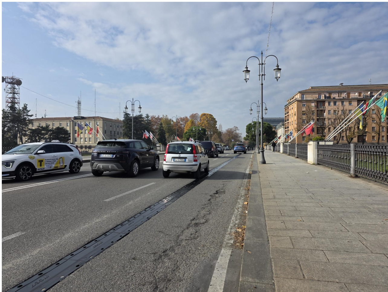
Fig. 11. Porzione ammalorata di asfalto
