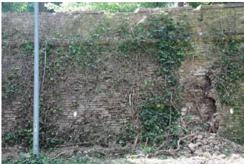
10. Attuale stato di conservazione del muro lato nord, di cui è già in progettazione e in previsione il restauro
