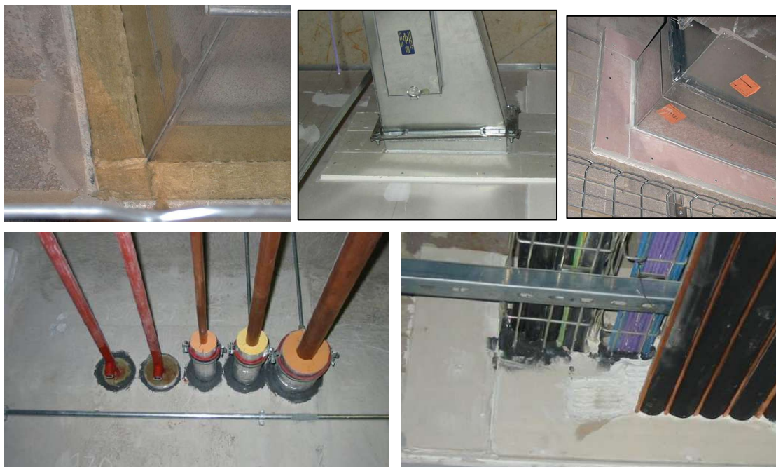
Fig.12 – Penetrazioni da canali/tubazioni
