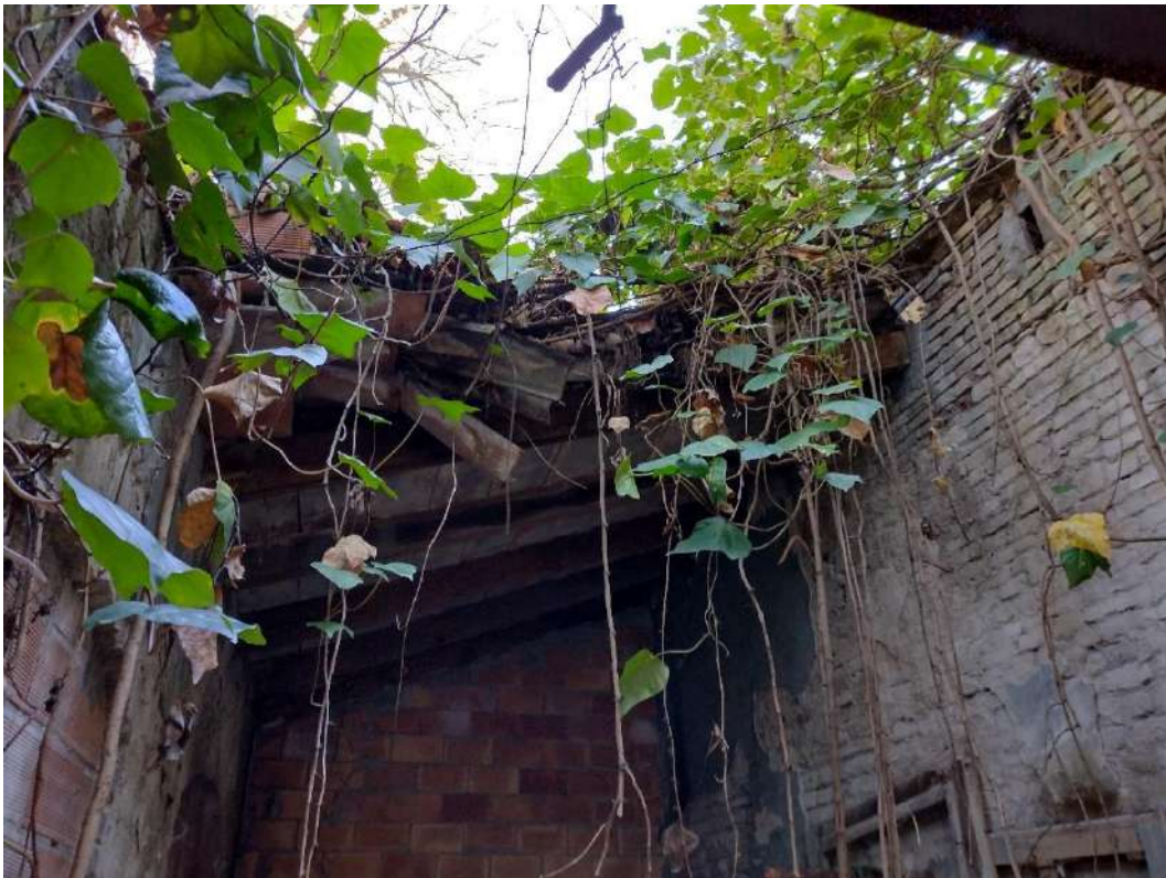
Stato di degrado
