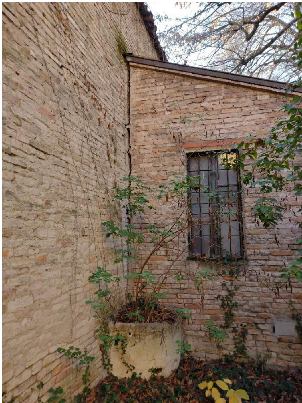
Mancanza di ammorsamento tra murature
