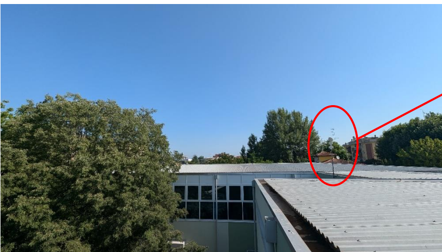
Gruppo antenne posizionate nel blocco di collegamento tra fabbricato nord e fabbricato centro. Non di particolare interesse ai fini dell'installazione del fotovoltaico
