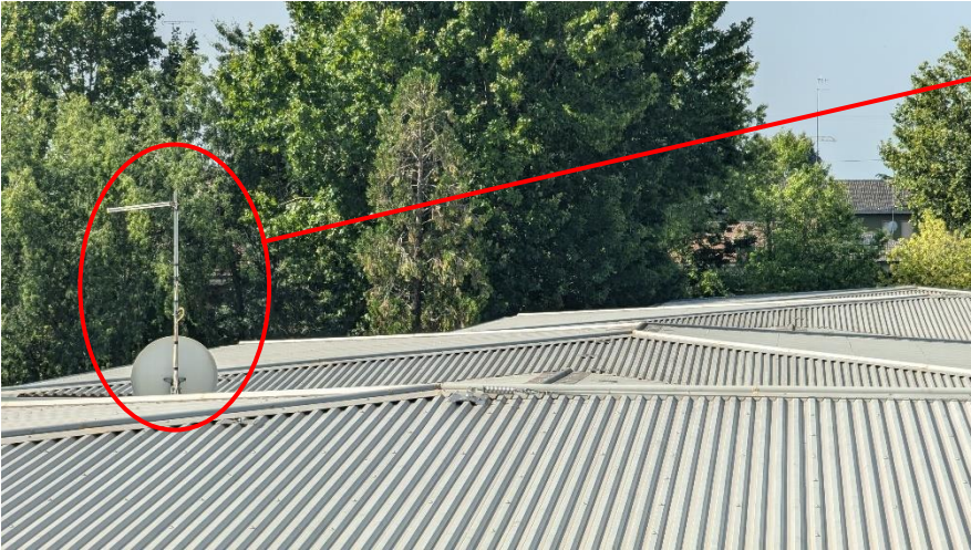
Gruppo antenne posizionate sul lato sud-est del fabbricato centro.
