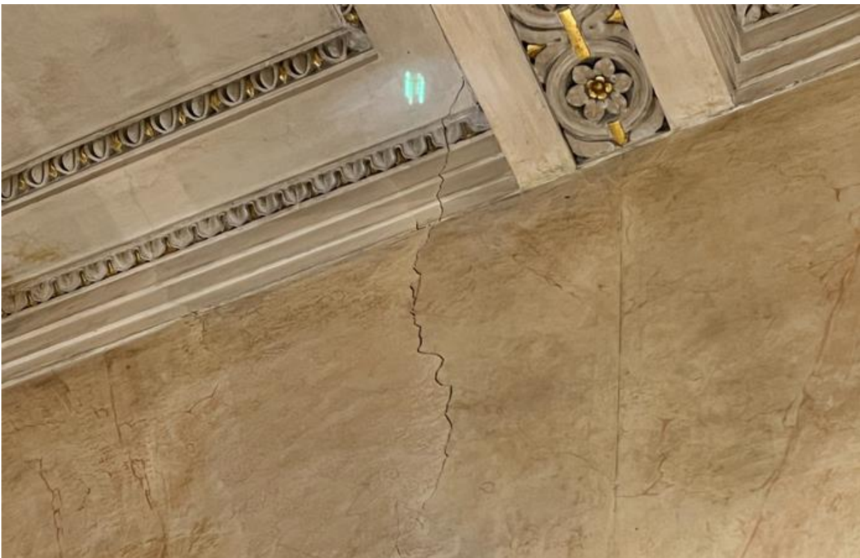
Figura 20 – Quadri fessurativi foyer
