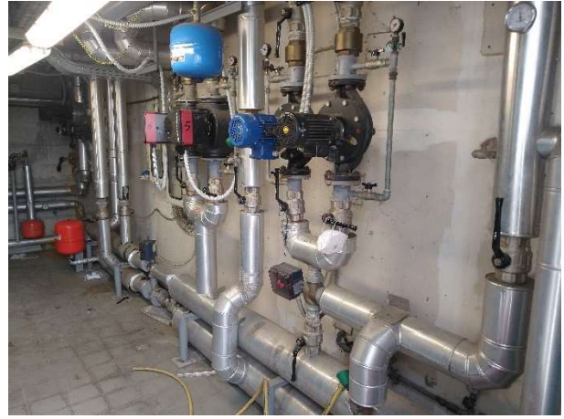
Vista di centrale con i gruppi di pompaggio
