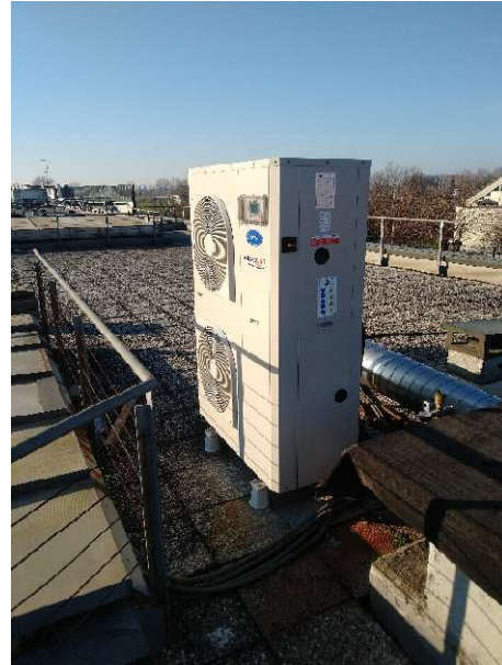
Chiller e condotto di estrazione del centro diurno
