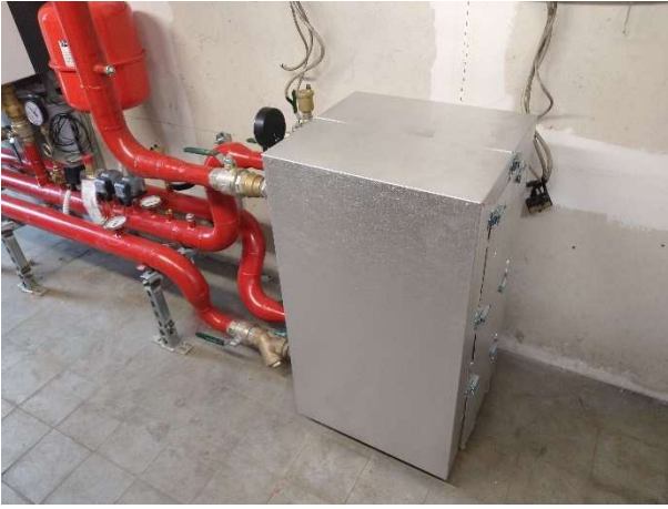
Scambiatore di calore caldaie
