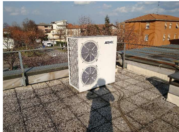
Chiller spazio associazione
