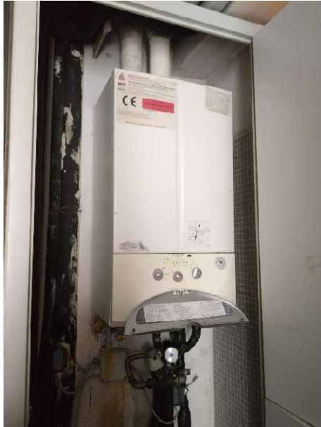
Caldaia tradizionale del centro diurno
