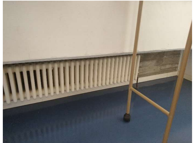
Radiatore tipo installato nei corridoi
